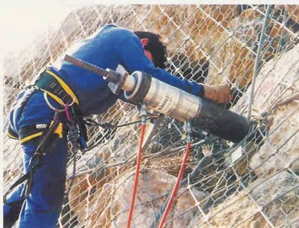
FIGURA 15. Tensado de anclajes II. Aplicación de precarga de 150 kN en el nudo de anclaje (intersección de los cables horizontales y verticales).
