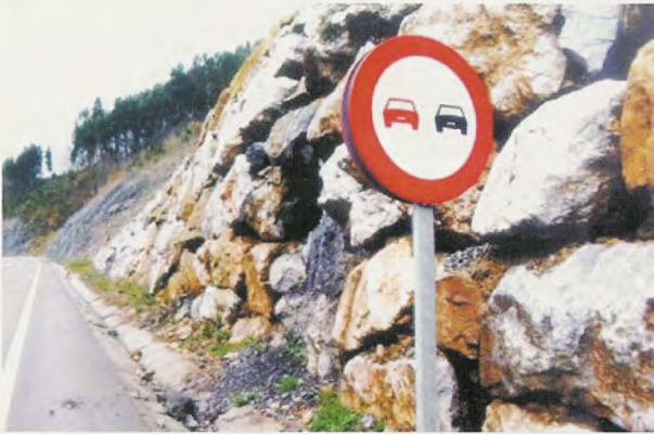
FIGURA 1. Desplazamiento de bloques de escollera.
