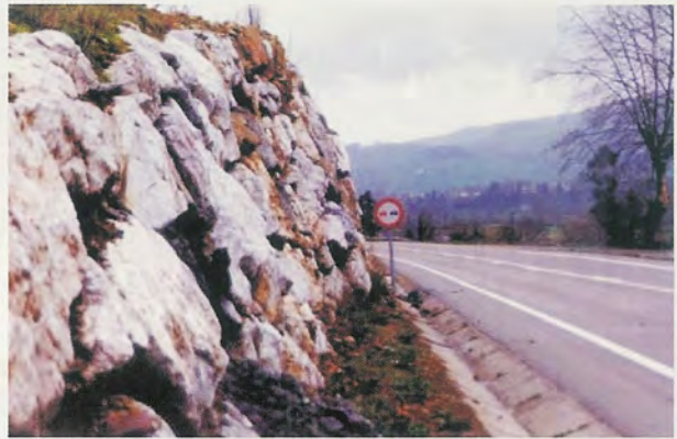
FIGURA 2. Formación de panza y desplazamiento de horizontal del muro.
